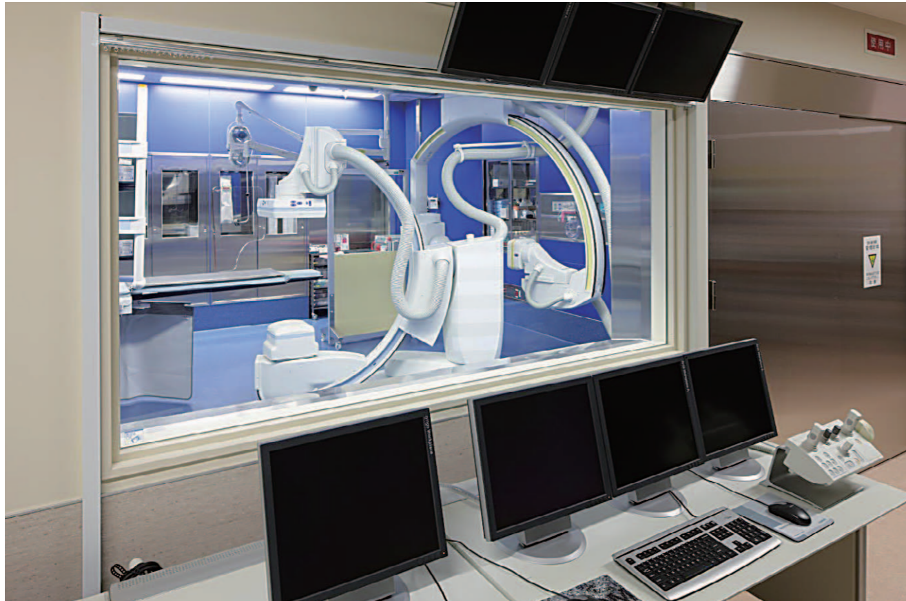
聖路加国際病院（アンギオ室）
