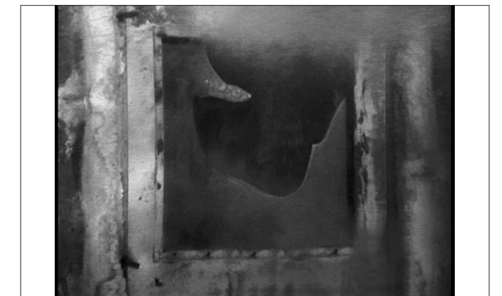
他の防火ガラス(急激な温度変化による破損)
