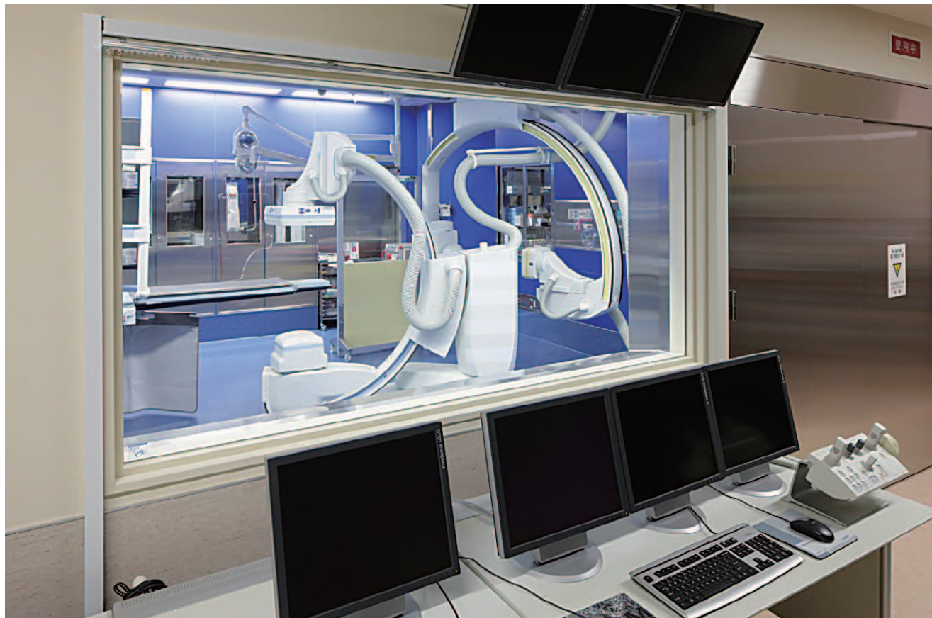
聖路加国際病院（アンギオ室）
